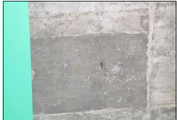
바닥판 콘크리트 박락(S4)
