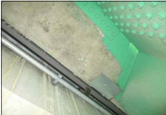
바닥판 콘크리트 들뜸(S1)
