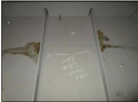
거더 내부 누수흔적(S1-G2)
