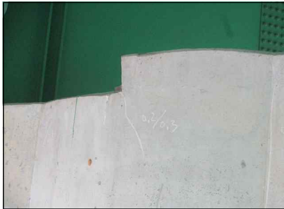
교각 코핑부 균열(P1)
