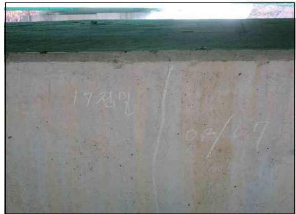
교각 코핑부 균열(P3)
