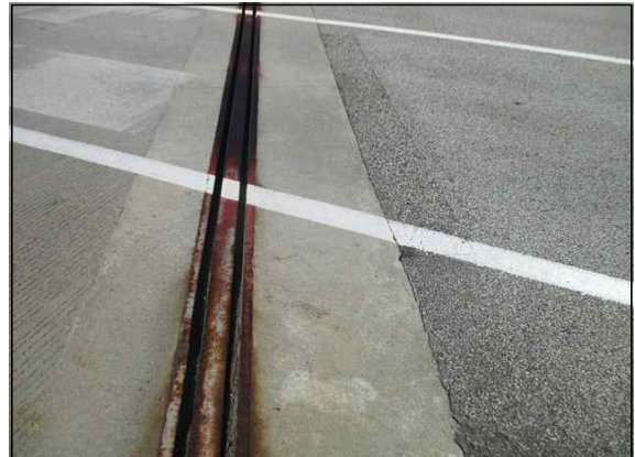
신축이음 후타재 균열(A2)
